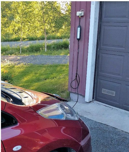
Kuva 1. Hidaslataus sähköauton mukana tulevalla kaapelilla kotitalouspistorasiasta (lataustapa 2).
