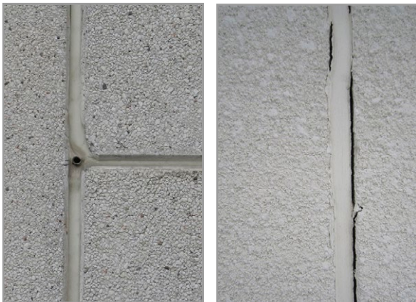
Kuva 7.19 Vasemman puoleisessa kuvassa saumat ovat tiiviitä ja elementtien alarunkissa on vedenpoistoputket. Oikeanpuoleisen kuvan sauma on epätiivis. Kuvat: M. Pitkäranta ja K. Laine, Vahanen Oy.
