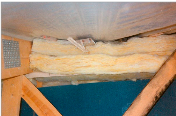
Kuva 7.72. Vesikaton aluskatteen ja lämmöneristevillan välistä tuuletusväliä on yritetty kuvan kohteessa korjata laudan pätkillä. Kuva: P. Laamanen, Vahanen Oy.
