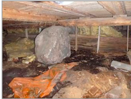
Kuva 7.99. Ryömintätila, jossa on rakennusjätettä ja esimerkkitapauksen vaurioitumisperiaate. Kuva: P. Räisänen, Vahanen Oy.
