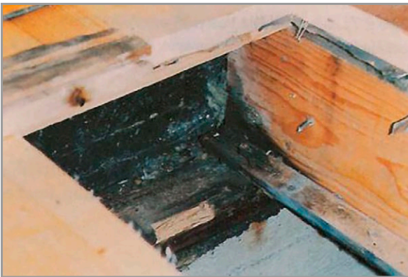
Kuva 7.88. Puualapohjan ja betoniperusmuurin vaurioitunut liitoskohta. Kuva: E. Kauriinvaaha, TKK, Talonrakennustekniikan laboratorio.
