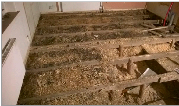
Kuva 7.104. Betoninen alalaattapalkkisto ja huonokuntoinen lat- tiakoolaus. Kuva: K. Viljanen, Vahanen Oy.
