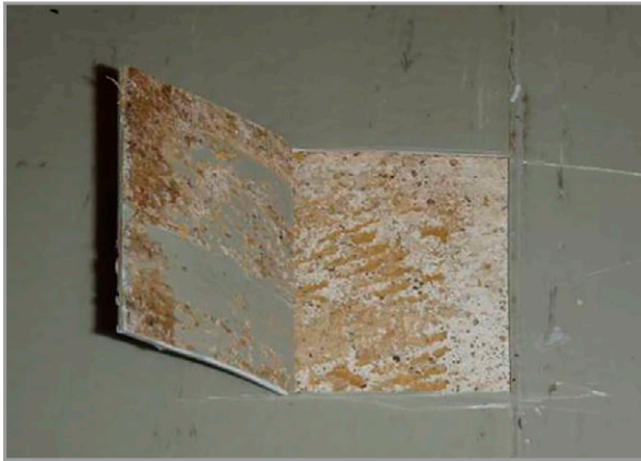
Kuva 7.107. Muovimatton kunnon tarkastuksessa havaittu värjäätynyt liima. Kuva: H. Tuovinen, Vahanen Oy.
