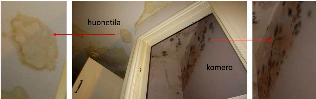
Kuva 6.13. Kosteusvauriojälkiä huonetilan ja suljetun komeron kattopinnoissa. Kosteusrasitus ja materiaalit olivat olleet molemmissa tiloissa samanlaiset, mutta huonetilan paremman tuulettuvuuden takia huoneen kattoon ei ollut syntynyt silminnäkyvää homekasvustoa. Molemmilla alueilla kattotasote ja maali olivat kuitenkin mikrobiviljelytutkimuksen perusteella mikrobivaurioituneet. Kuvat: S. Niemi, Vahanan Oy.
