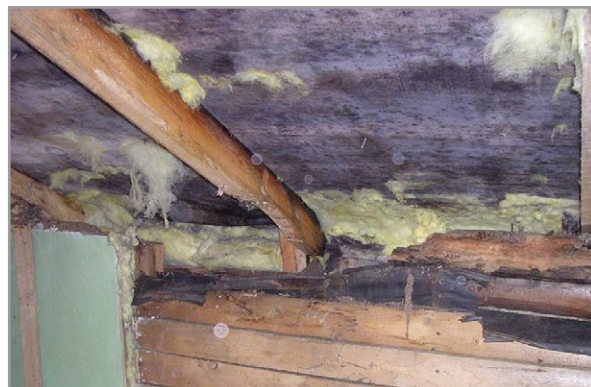
Kuva 7.73. Yläpohjan lämmöneristeiden asennus kiinni aluskatteen on aiheuttanut yläpohjarakenteisiin kosteusvaurioita. Kuva: T. Manninen, Vahanen Oy.
