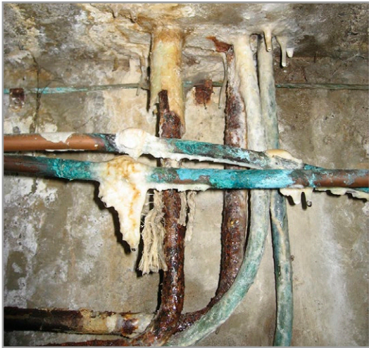
Kuva 7.41. Rakenteen sisäisen putkivuodon ilmeneminen rakenteen pinnalla. Kuva: E. Salo, Vahanen Oy.
