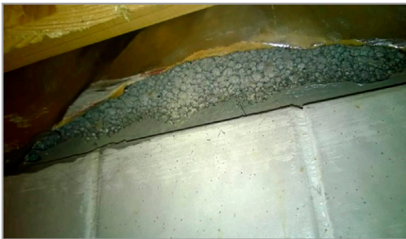
Kuva 7.93. Saunan maanvastaisessa kevytsoraharkkoseinässä havaittu höyrynsulun epätiivisyyskohta seinän alaosassa. Kuva: K. Viljanen, Vahanan Oy.
