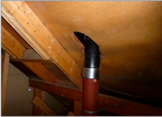
Kuva 7.70. Aluskatteen ja läpiviennin epätiivis liitos. Kuva: P. Räisänen, Vahanen Oy.
