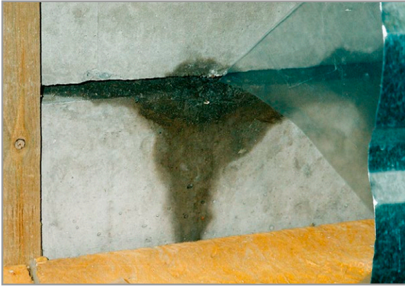
Kuva 7.44. Epätiivin julkisivuelementin sauman läpi on tunkeutunut sadevettä elementin sisäpuolelle. Kuva: P. Laamanen, Vahanen Oy.
