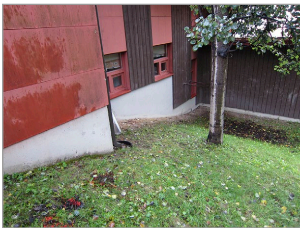
Kuva 7.78. Rakennukseen päin viettävä maanpinta johtaa pintavedet sokkelin viereen. Kuva: J. Saarinen, Vahanan Oy.
