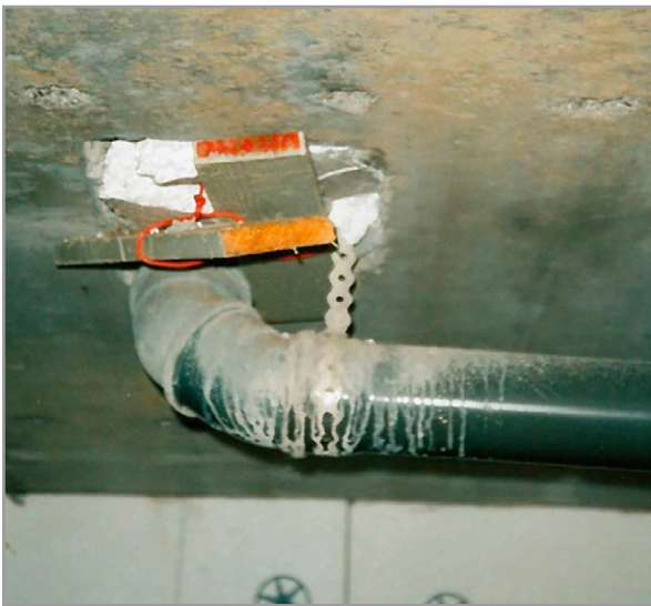
Kuva 7.102. Ryömintätilan puolelta kuvattu alapohjan epätiivis läpivienti. Betonisen alapohjan alapinnassa on homeetta. Kuva: P. Laamanen, Vahanan Oy.
