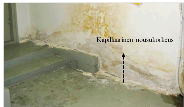
Kuva 5.19. Kapillaarinen maakosteuden nousu on johtanut tasoitteen ja maalin irtoamiseen väliseinän alaosaan. Kuva: J. Ahokas, Vahanen Oy.
