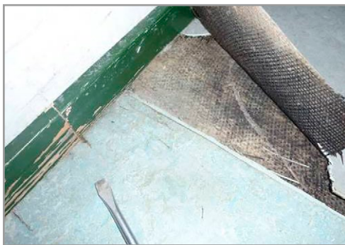
Kuva 7.105. Mikrobivaurioitunut linoleumimatto. Kuva: H. Tuovinen, Vahanen Oy.
