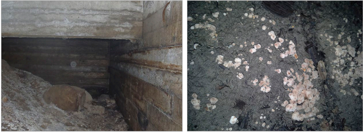
Kuva 6.10. Mikrobikasvua tuulettuvassa alapohjatilassa paljaana olevan savimaan pinnassa. Kuvan ryömintätilasta puuttuu kunnollinen sepelöinti, salaojitus on puutteellinen ja tilan ilmanvaihtuvuus maapohjan kosteustuottoon nähden liian pieni. Mikrobikasvustoja esiintyi runsaasti, vaikka maapinnalla oli vain vähän orgaanista rakennusjätettä. Kuvat: H. Keinänen, Vahanen Oy.
