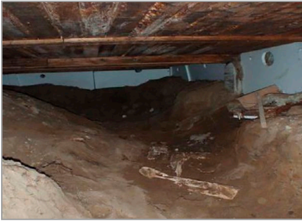
Kuva 7.97. Liian korkean kosteustuoton aiheuttama kosteus- ja homevaurio ryömintätilassa. Maatäyttö on hienorakeista hiekkaa joka mahdollistaa kosteuden siirtymisen kapillaarisesti maanpinnalle. Lisäksi ryömintätilan korkeus on matala ja tuulettuminen puutteellista. Kuva: P. Sekki, Vahanen Oy.
