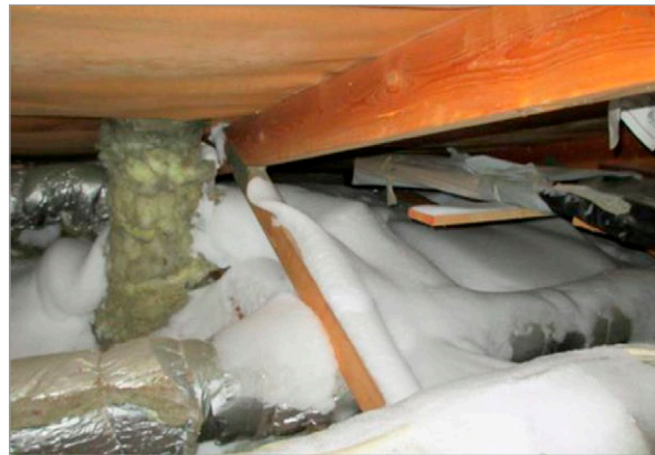
Kuva 5.3. Eräässä ullakotilassa tuiskulumi poistui ilmaan sublimoitumisen, sulamisen ja haihtumisen yhteisvaikutuksesta. Yläpohjassa oli 200 mm mineraalivilla ja kate oli tumma kuitusementtilevykate. Ullakotilan tuulettavuus oli voimakas. Kuva: P. Sallinen, Vahanen Oy.
