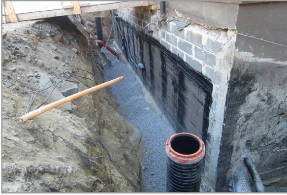
Kuva 7.87. Salaojajärjestelmän rakentaminen korjauskohteessa. Kuvassa näkyy rakennuksen viereinen kaivanto sekä siihen sijoitetut salaojaputket ja tarkastusputki sekä perusmuurin vedeneristys. Kuva: J. Ahokas, Vahanan Oy.
