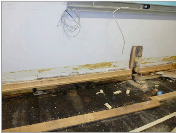
Kuva 7.95. Alapohjarakenteessa tapahtuneen vesivuodon aiheuttama kosteusvaurio puukoolauksessa. Esimerkkitapauksen vaurioitumisperiaate.
