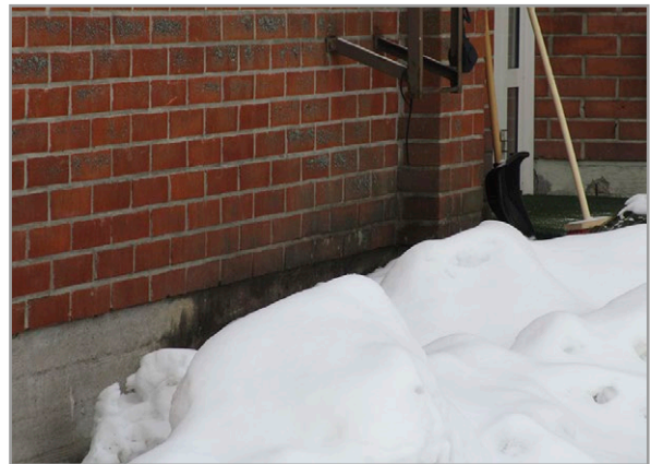
Kuva 7.18. Lumen kasaaminen seinustalle on kastellut tiiliverhoillun, puurunkoisen ulkoseinän alaosan. Kuva: M. Pitkäranta, Vahanen Oy.
