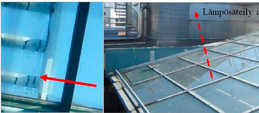
Kuvat 5.28. Kosteus voi kondensoitua lasikaton alapintaan yön vastasäteilyn vaikutuksesta. Kuvat: J. Ahokas, Vahanen Oy.
