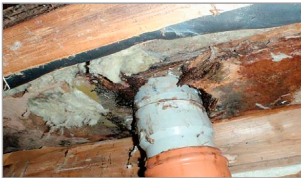
Kuva 7.96. Virheellisesti asennetun viemärin aiheuttama kosteusvaurio. Kuva: P. Sekki, Vahanan Oy.
