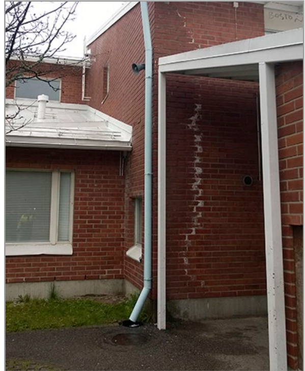
Kuva 7.82. Puutteellinen katon vedenpoisto johtaa sadevedet tiilijulkisivuun. Kuva: J. Saarinen, Vahanen Oy.
