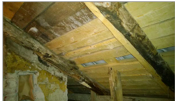
Kuva 7.61. Savuhormin juuripellin vuodosta kosteusvaurioitunut avattu yläpohjarakenne. Kuva: K. Viljanen, Vahanen Oy.
