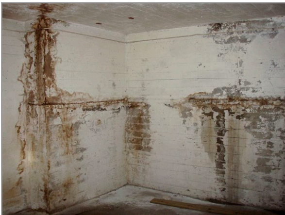
Kuva 7.85. Vuotava kellarin seinän halkeama ja esimerkkitapauksen periaate. Valokuva: E. Kauriinvaha, Vahanen Oy.
