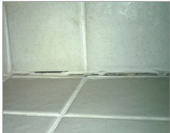
Kuva 7.39. Märkätilan joustava saumaus on revennyt tartuntapinnostaan lattia-seinäliittymässä. Kuva: K. Viljanen, Vahanen Oy.
