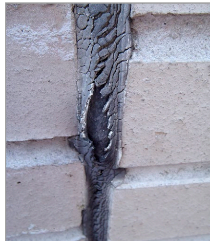
Kuva 7.43. Julkisivuelementin sauma on vaurioitunut. Saumassa on selvä reikä. Kuva: T. Lammi, Vahanen Oy.
