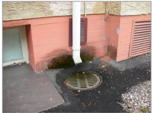
Kuva 7.83. Vettä roiskuu seinälle ja kastelee kellarin seinää. Kuva: T. Väisänen, Vahanen Oy.
