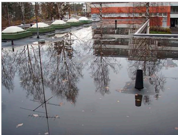
Kuva 5.21. Puutteellinen kattovesien poisjohtaminen aiheuttaa veden lammikoitumista loivalle kermikatolle. Paineellinen vesi voi tunkeutua rakenteisiin, mikäli vesikate on epätiivis. Kuva: E. Kauriinvaaha, Vahanen Oy.
