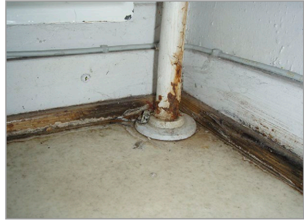
Kuva 7.12. Vuotavan vesiputken aiheuttama kosteusvaurio lattiasa ja jalkalistassa. Kuva: E. Kauriinvaaha, Vahanen Oy.
