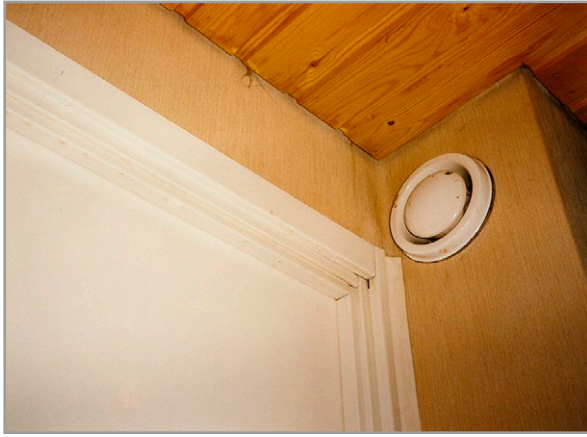
Kuva 7.11. Märkätilan tuuletuksen kannalta epäedullisesti sijoitettu poistoilmaventtiili. Kuva: P. Jäppinen, Vahanen Oy.
