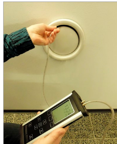
Kuva 3.22. Ilmamäärän mittaaminen poistoilmapäätelaitteesta hupulla (vasen) ja paine-eromittauksella (oikea). Kuvat: J. Dahlström, Instakon Oy.
