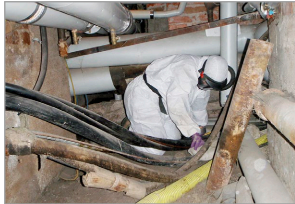
Kuva 3.24. Kuntotutkijan työhön liittyy erilaisille haitallisille aineille altistumisen riski. Kuvassa on asianmukaisesti suojautunut kuntotutkija tuulettuvassa alapohjatilassa, jossa oli mm. rikkoutuneita asbestipitoisia putkieristeitä ja mikrobikasvustoja. Kuva: H. Tuovinen, Vahanen Oy.
