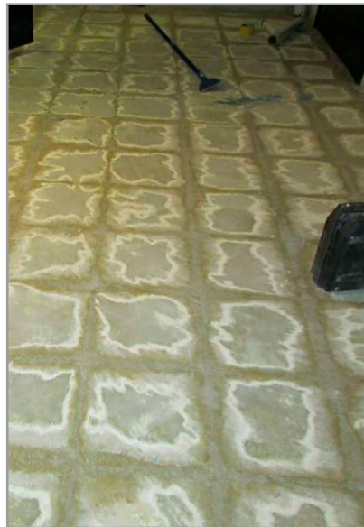
Kuva 7.106. Poistettujen kvartsivinyylilaattojen alta paljastui kostea betoni. Kuva: H. Tuovinen, Vahanen Oy.
