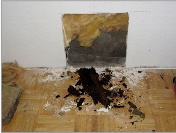
Kuva 7.32. Kapillaarisen veden nousun aiheuttama kosteusvaurio maanvastaisen seinän alaosassa. Valesokkelirakenteen alaoheisuus on lahonnut. Kuva: J. Saarinen, Vahanen Oy.
