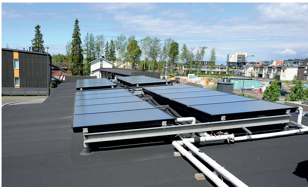
Kuva 39. Aurinkolämpökeräimet on asennettu ulkorakennuksen katon suuntaisesti lähes vaakasuoraan asennuskulmaan.
