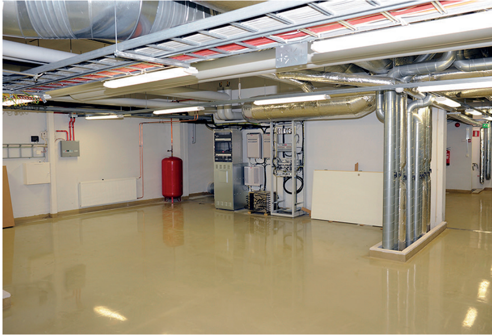
Kuva 16. Onnelanpolun teknisessä tilassa on runsaasti tilaa järjestelmälaajennuksille.
