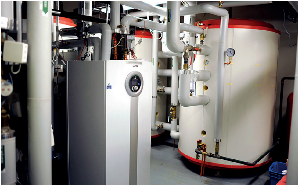
Kuva 3. Maalämpöpumppu ja vesivaraaja Jampankaaren palvelutalon teknisessä tilassa.
