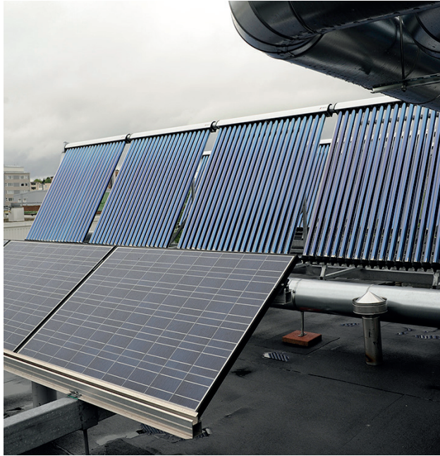
Kuva 9. Aurinkolämpökeräimiä ja aurinkosähköpaneeleja asennettuna opiskelija-asuntola Puusepän katolle.
