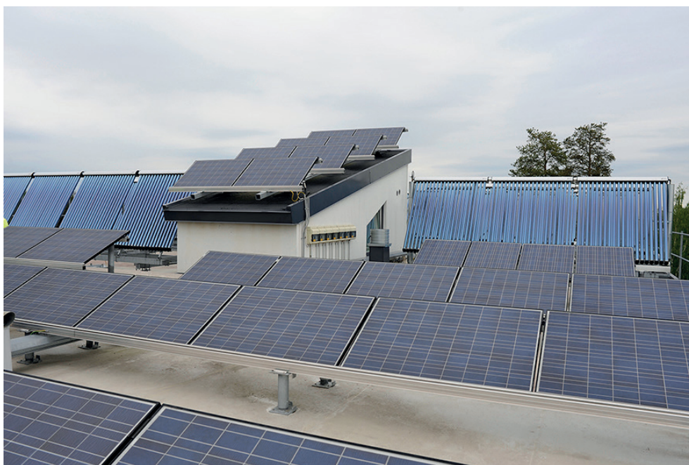
Kuva 2. Aurinkosähköpaneeleita ja aurinkolämpökeräimiä Jampankaaren palvelutalon katolla. Sijoittelussa on pyritty minimoimaan rakenteiden synnyttämät varjostukset.
