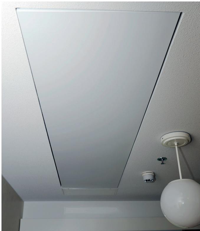
Kuva 31. Lämpö ja viileä jaetaan huoneistoissa vesikiertoisilla kattosäteilylämmittimillä.
