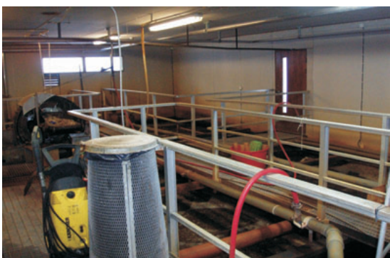
Kuva 10. Kirveskosken jätevedenpuhdistamo (Hanna Yli-Tolppa).
