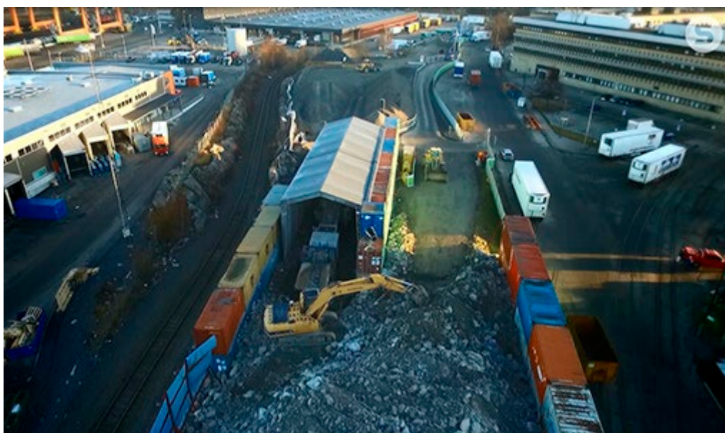
Kuva 14. Årstan rakentamisen tukialue Tukholmassa alle hehtaarin tontilla tuottaa n. 300 000 tonnia kiviaineksia rakentamiseen: etualalla louheen vastaanotto, esimurskaimen syöttö ja taka-alalla varastokasat ja kuormien lastaus (kuva: Antti Heiskanen).
