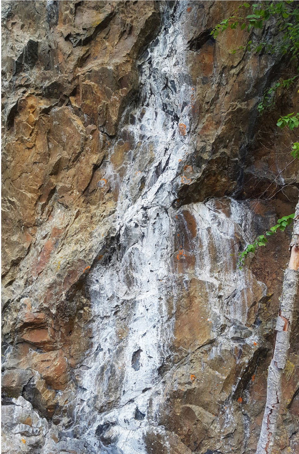
Kuva 9.45. Kalkin ja kipsin sekaista valkoista saostumaa Heinolan Piimävuoren (KA0060012) kallioseinämällä. Kuva: Alexander Leppäkoski.
