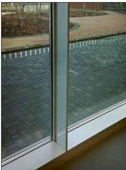
Kuva 3. Vaarallinen teräväreunainen ikkunaprofiili vuonna 2010 valmistuneen koulun liikuntatilassa (kuva: Mikko Helasvuo)
