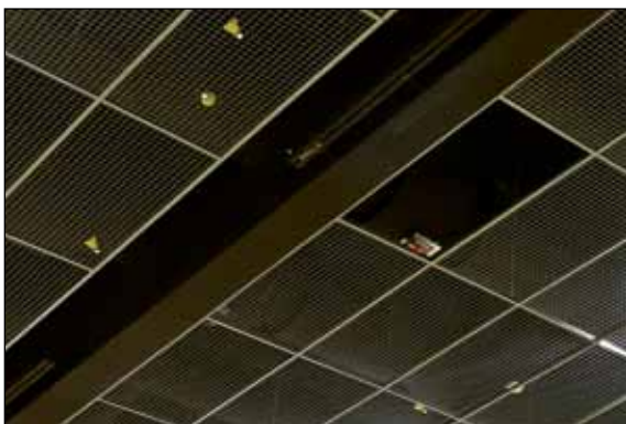
Kuva 5. Liikuntasalin vaarallinen alakatto, jonka yksi verkkoelementti on pudonnut. Pallot jäävät verkkoelementin päälle. (kuva: Mikko Helasvuo)
