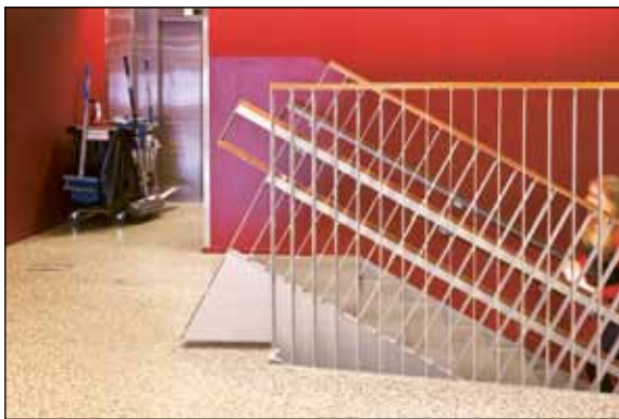
Kuva 7. Kompastumis- ja takertumisvaaran aiheuttava kaiderakenne. Askelmista puuttuvat kontrastiraidat. Hyvä ratkaisu on kahdelle eri korkeudelle asennetut käsijohteet. (kuva: Mikko Helasvuo)
