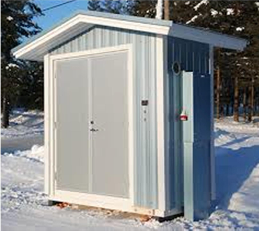
Kuva 9 Lämmin laitetila (Esari Oy)
