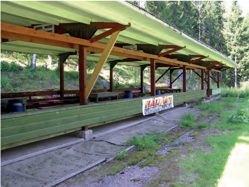
Kuva 9.10. Nokian pistooliradan avoin katos ilman meluntorjuntarakenteita.
