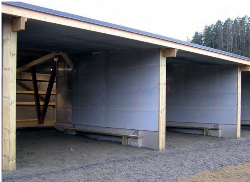
Kuva 9.8. Katos, jossa 4,6 m pitkät vaimentavat sivuseinäkkeet.
