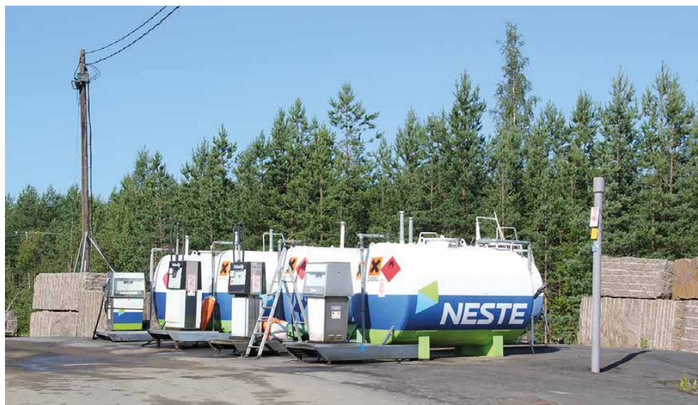
Kuva 42. VnA 444/2010 mukainen nestemäisten polttoaineiden jakeluasema louhimon tukitoiminta-alueella. Kuva: Maria Palin.
