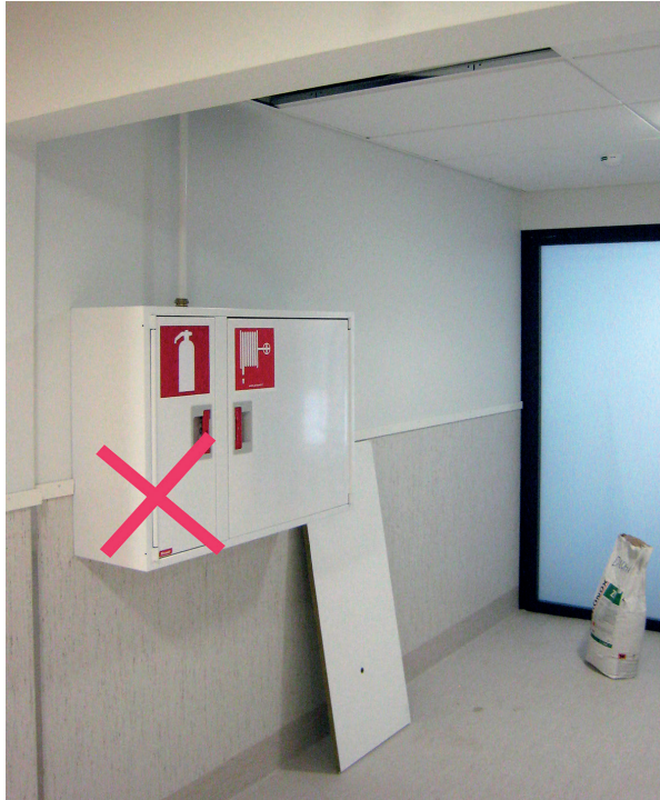
Kuva 41. Tässä on esimerkki huonosta ratkaisusta, jossa on ilmeinen törmäysvaara. Pyörätuolinkäyttäjän voi olla vaikea huomata miltei seinän väristä ja liian ulos seinästä tulevaa vaarallista kulmaa, johon voi lyödä päänsä.
