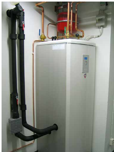
Kuva 4: Lämpöpumppu varaajineen tarvitsee riittävästi tilaa (Kuva: Jouni Lehtonen)
