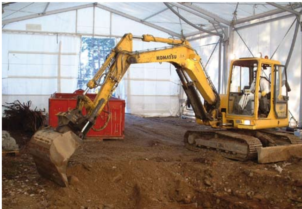
Kuva 14. Telttakaivussa haitta-aineet ja pakokaasut konsentroituvat helposti. Pakokaasut on johdettava pakokaasuimurilla ulos. Kuva: Ilpo Ahonen
