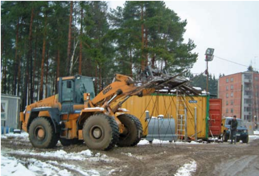
Kuva 11. Työmaaliikenne voi aiheuttaa vaaratilanteita. Kuva: Jorma Lappalainen
