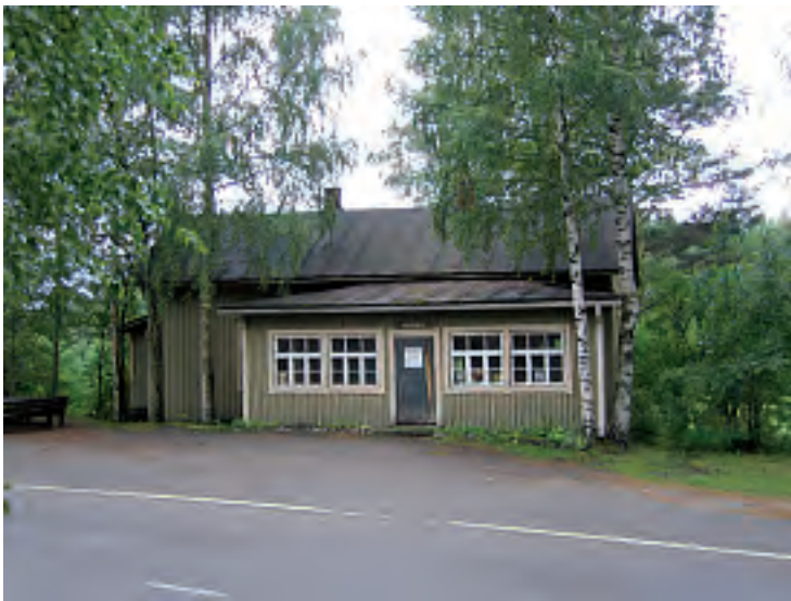
Kangaslammien museon katto oli mennyt huonoon kuntoon. Rakennuksen vieressä kasvavat puut vaurioittivat osaltaan rakennusta.
