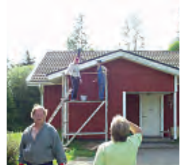
Kerkonkosken vuokratalot maalattiin myös työkauden aikana. Maalaustyön edistymistä seuraa projektipäällikkö Pirjo Karinen.
