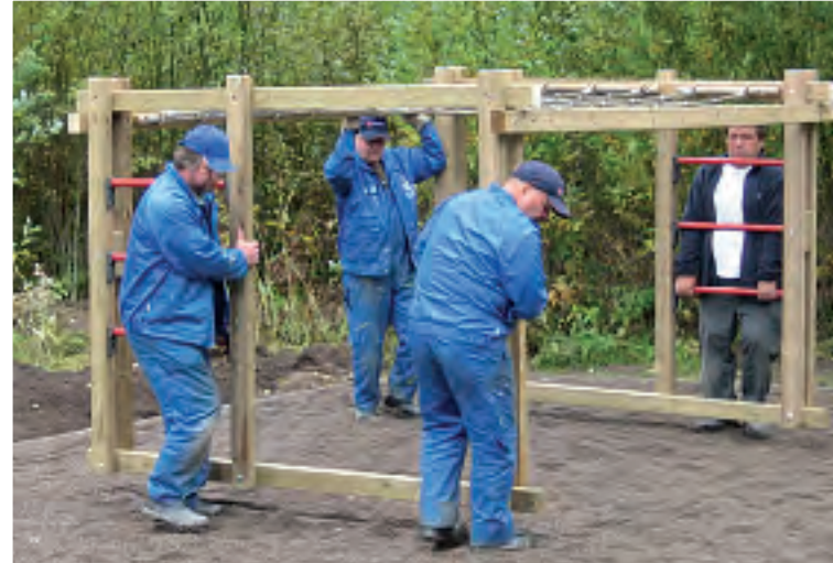
Kangaslammin leikkikentän kaikki kalusteet uusittiin uusien turvamääräysten mukaiseksi. Työsuunnittelija Veijo Juuti avustaa työntekijöitä kiipeilytelineen paikoilleen asentamisessa.
