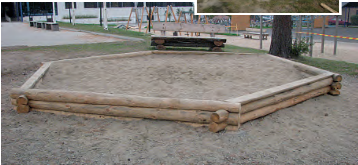
Siikalammen leikkikentälle tehtiin kuusikulmainen hiekkalaatikko. Hiekkalaatikkoa varten hirret kuorittiin ja salvokset tehtiin varikolla, jonka jälkeen hirret siirrettiin Siikalammen leikkikentälle.
