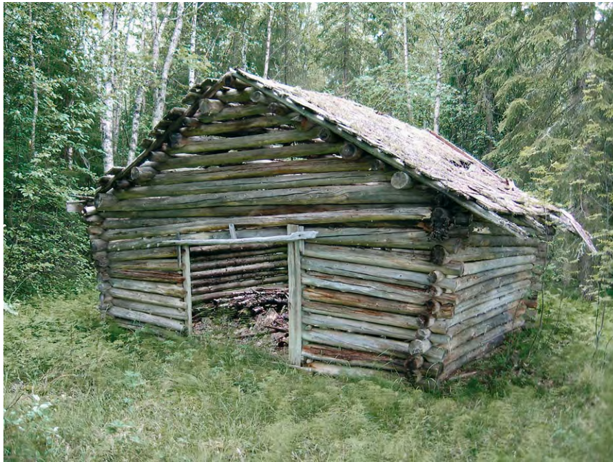
Kunnostuksen tarpeessa oleva lato Louesaaren tulvaniityllä.
