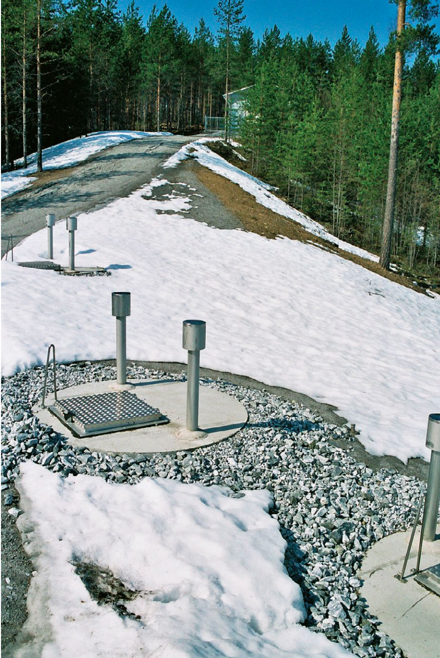
Kuva 8. Sulkavan kunnan vedenhankintaa palveleva Kirkkokankaan vedenottamo. Kuva: Anne Petäjä-Ronkainen.
