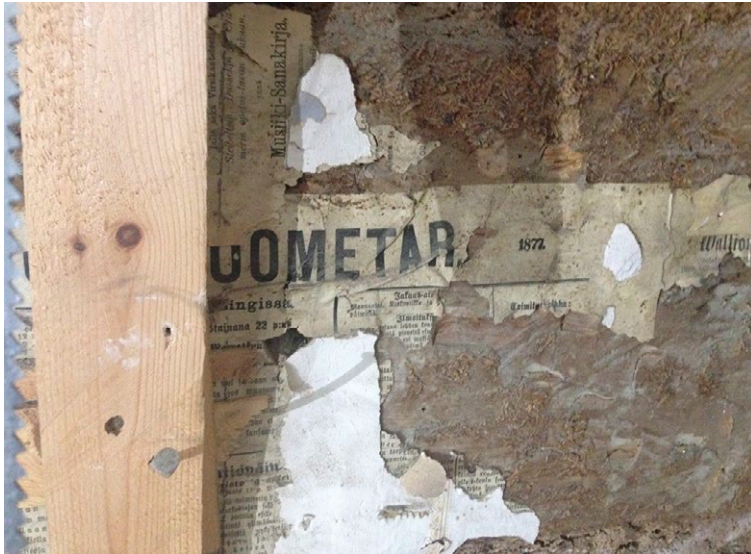
Kuva 16. Sisäseinien pintojen purun alta paljastui alkuperäisiä rakenteita ja rakennusmateriaaleja. Kuvassa pala Uusi Suometar sanomalehteä vuodelta 1877, jota on käytetty rakennusmateriaalina (kuva Kari Nöjd).
