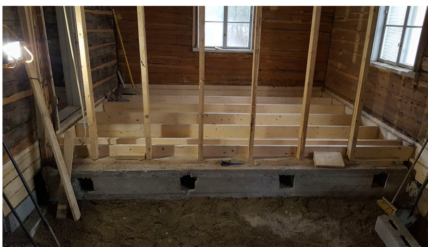
Kuva 13. Laajennusosan rossipohja, alemmat uusitut hirsikerrat ja uusi lattia rakenteilla. Kuvassa vasemmalle jäävä osa on alkuperäistä multapenkille perustettua aluetta (kuva Jyri Nieminen).
