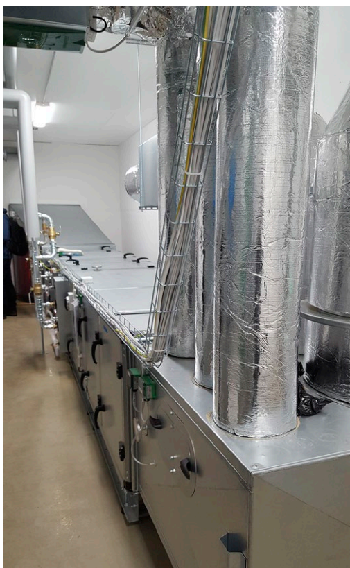
Kuva 32. Ullakkotilaan asennettu uusi ilmanvaihtokone. Ilmanvaihtokoneiden koot ovat tänä päivänä isoja verrattuna aikaisempien vuosikymmenten ilmanvaihtokoneisiin (kuva Jyri Nieminen).
