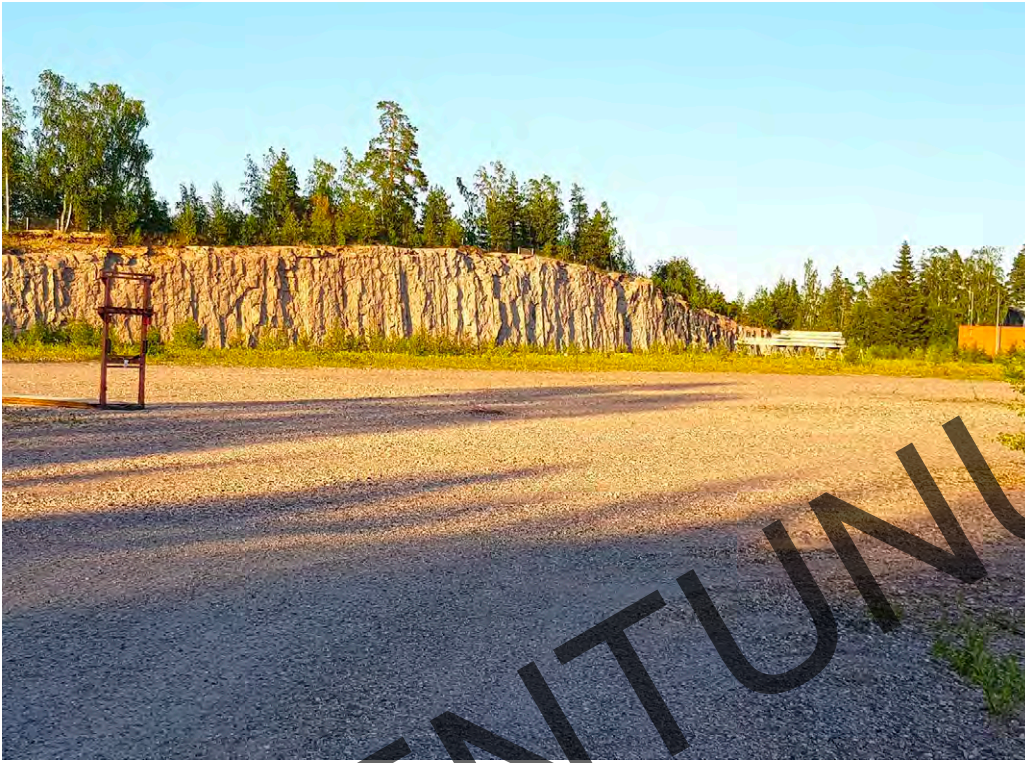
Kuva 15. Asemakaava-alueella voidaan tarvita maa-aineslupa, mikäli kaavassa rakentamista varten osoitettu laaja alue tasataan louhimalla valmiiksi ennen varsinaista rakentamista.
