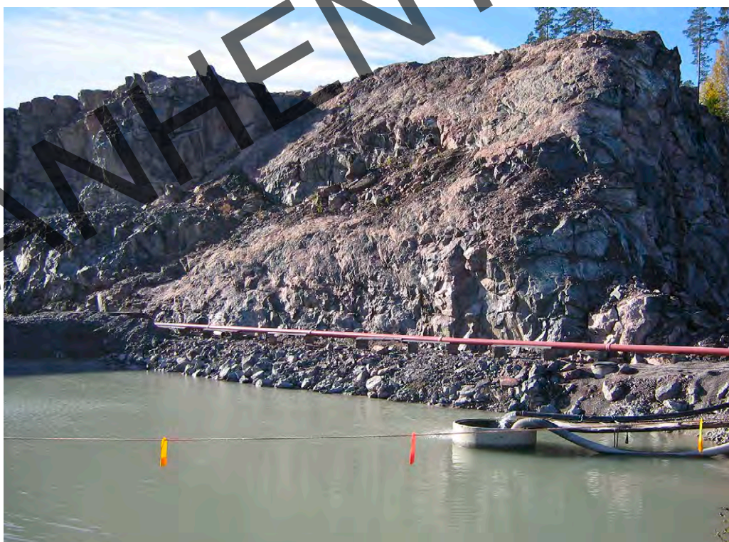
Kuva 28. Ottamisalueelta ei saa kulkeutua pintavesien valuman mukana haitallisia aineita ympäristöön. Tarvittaessa vedet johdetaan selkeytysaltaan kautta ennen kuin ne johdetaan ottamisalueen ulkopuolelle.
