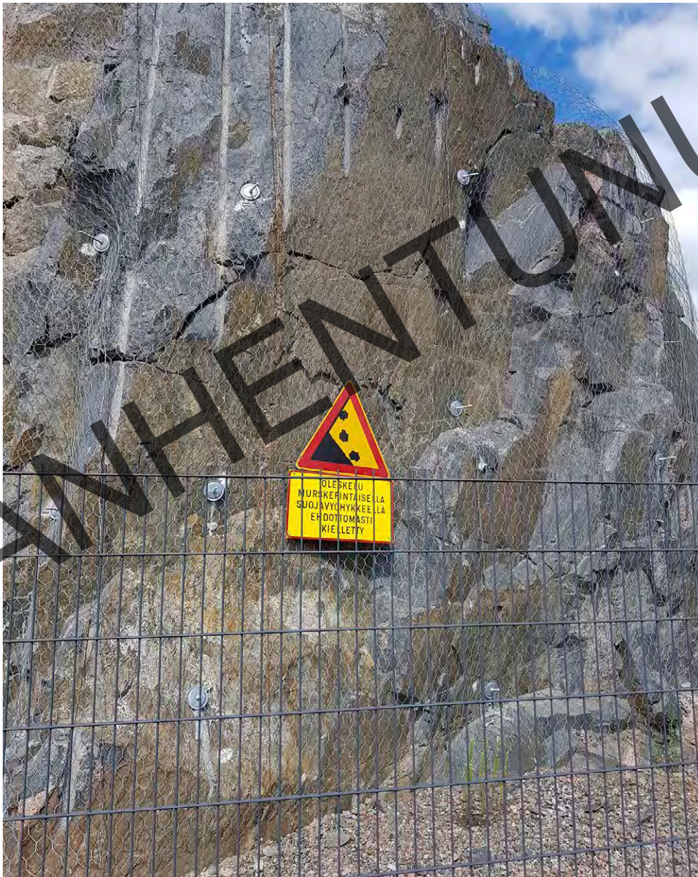
Kuva 47. Mikäli kallion ottamisalueelle jätetään jyrkkiä seinämiä, tulee huolehtia niiden turvallisuudesta. Turvallisuutta voidaan tarvittaessa parantaa esimerkiksi suojarakenteilla.
